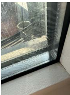
Delaminert glass på stuevindu.
