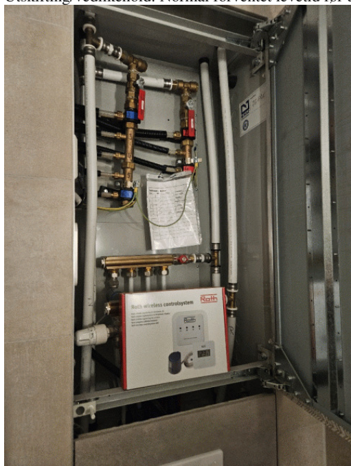
TG iu 6.2 Varmtvannsbereider
