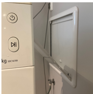
Tilgang til fordelerskap på vaskerom i 1. etg.
