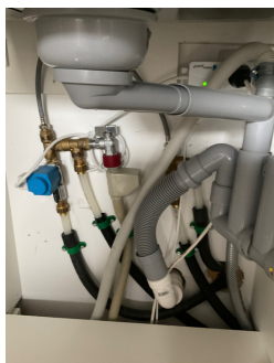
Røropplegg i kjøkkenbenk med WaterGuard
