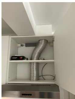
Avtrekkskanal ført ut ved innkassing
