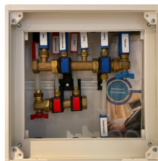
Rørfordeling på badrom 1. etg.
