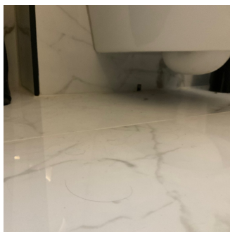
Lekkasjevarlser med spalte under veggmontert toalett
