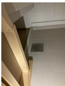
Sluk i bod hvor bereder er installert
