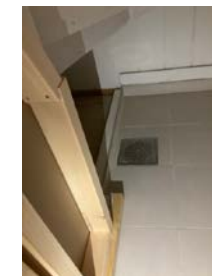
Sluk i bod hvor bereder er installert
