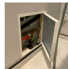
Tilgang til stoppekran ved hovedinntak på vaskerom 1. etg.
