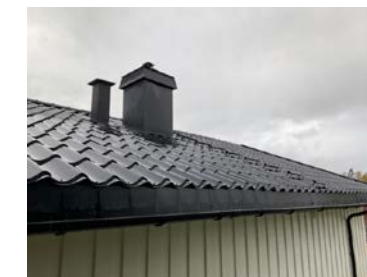
Pipehatt for fyring og lufting er ikke i bruk
