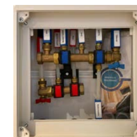
Rørfordeling på badetrom 1. etg.
