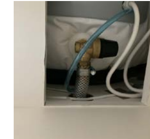
Bereder i kjøkkenbenk, avløp fra sikkerhetsventil og fast EL-tilkopling
