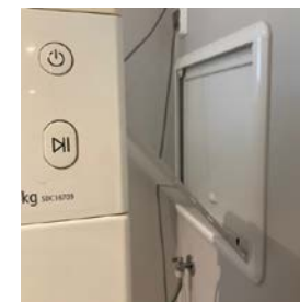
Tilgang til fordelerskap på vaskerom i 1. etg.
