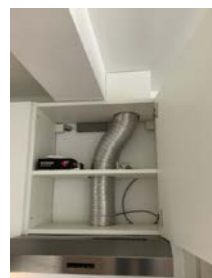
Avtrekkskanal ført ut ved innkassing
