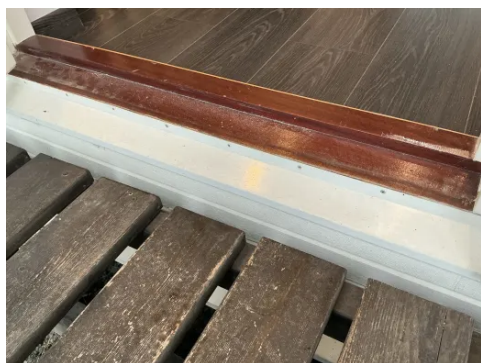
Feil montering av beslag under entrédør.
