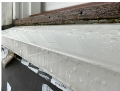
Feil montering av beslag under altandør.
