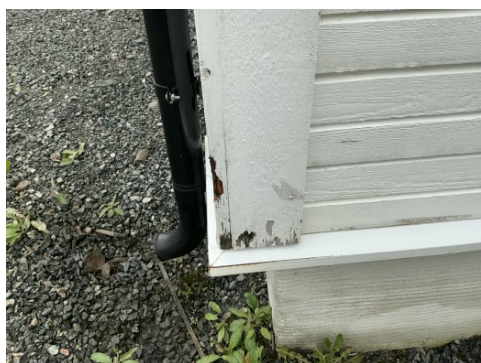
Råteskade på hjørnebord.
