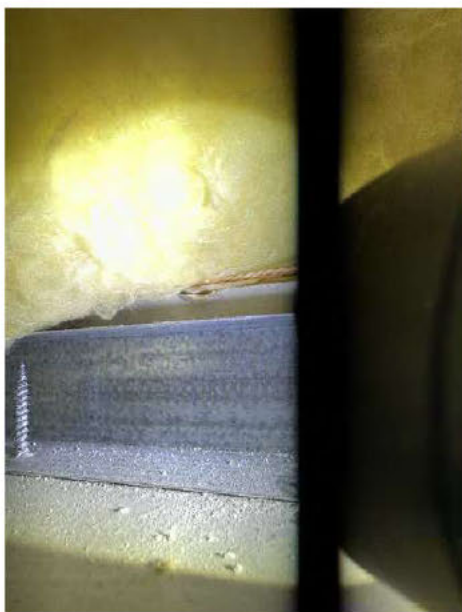
Himling B: Perforert med bore hull, utført på fellesbefaring. Dette er brannskille, tiltak er ikke søkt om.
