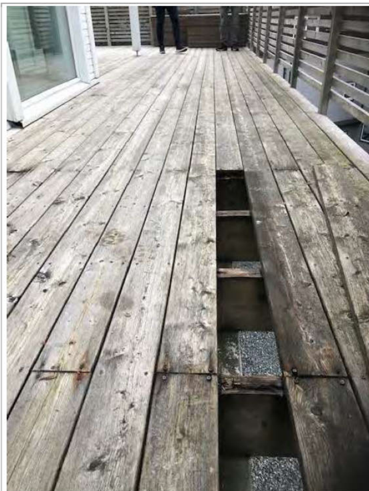
Oversikt bjelker og dekke er råteskadet
