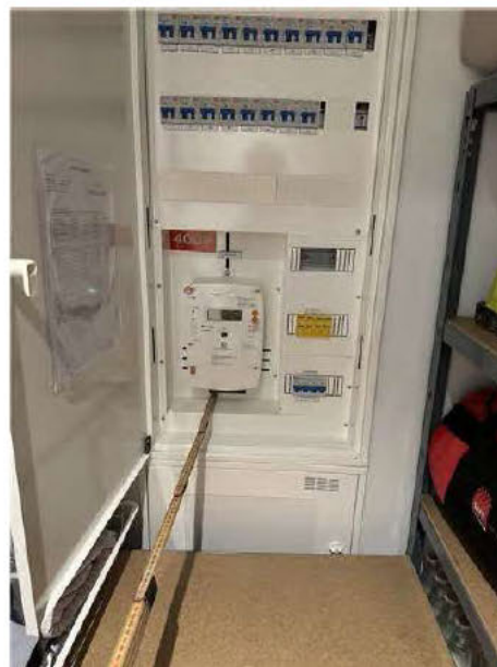
Sikringskap A: Er montert inn i brannvegg, ca. 20 cm. To lag gips i ytterkant.
