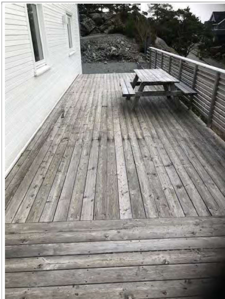
Oversikt terrasse dekket med em del råteskader
