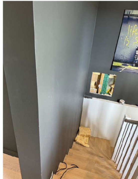
Det ble ikke registrert forhold som bryter med forskriftskrav for oppbygging av brann og lyd krav.
