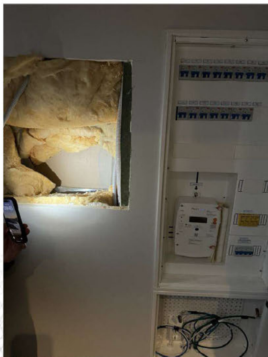
Fra 331 A sin del i 1.etg er det åpnet i skillevegg mot 331 B. Påvist feil oppbygging mtp. bla. brannskille.
