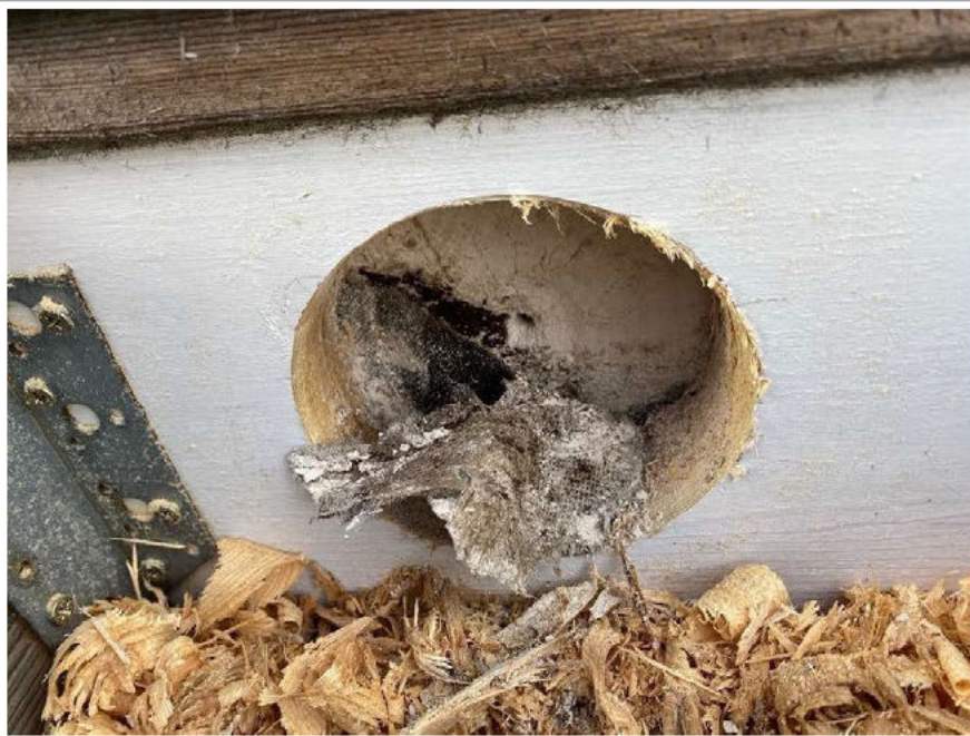
Råteskadet på kantbjelken til bjelkelaget.
