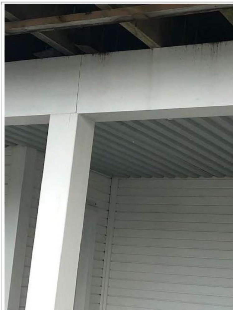
Oversikt limtre i område der det er råteskade på limtre.
