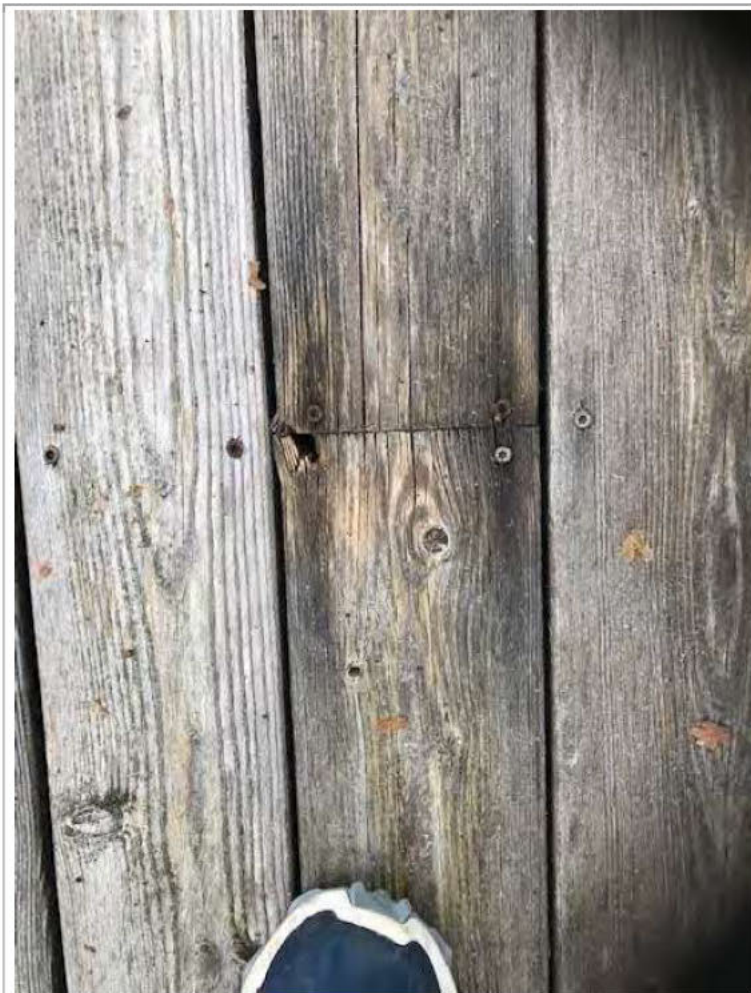
Påbegynne råte skade
