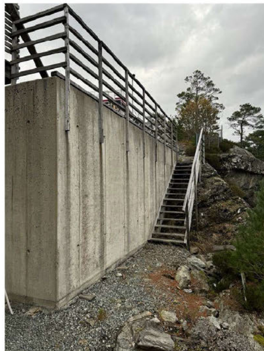
Trevirket er av en tilstand som gjør at avgrensning og sikring må utføres, for å sikre mot personskader.
