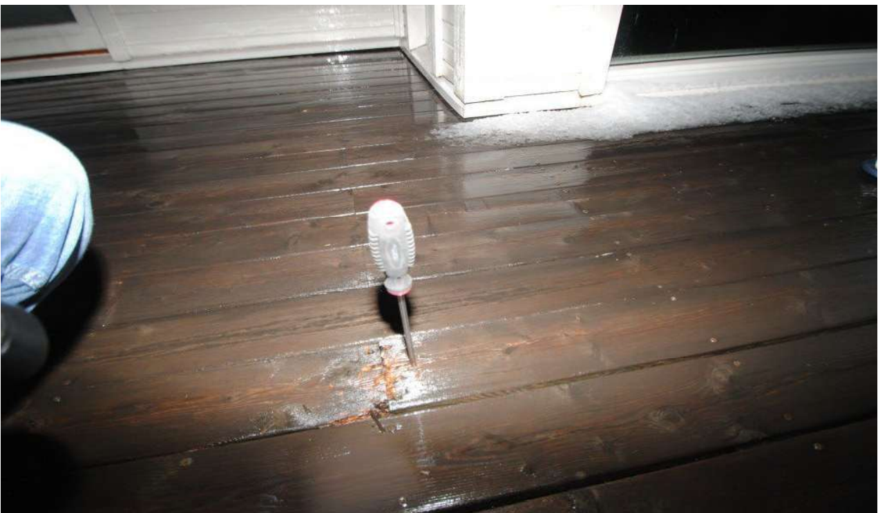
Bilde 4: Råteskader i bord og bjelke, et annet sted
