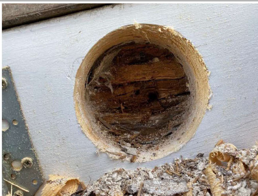
Råteskadet på kantbjelken til bjelkelaget.
