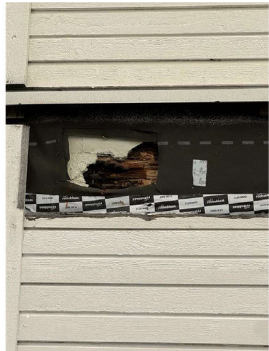
Vår befaring 25.10.2024. Skaden ser lik ut, men forverret tilstand i fasadekledning.
