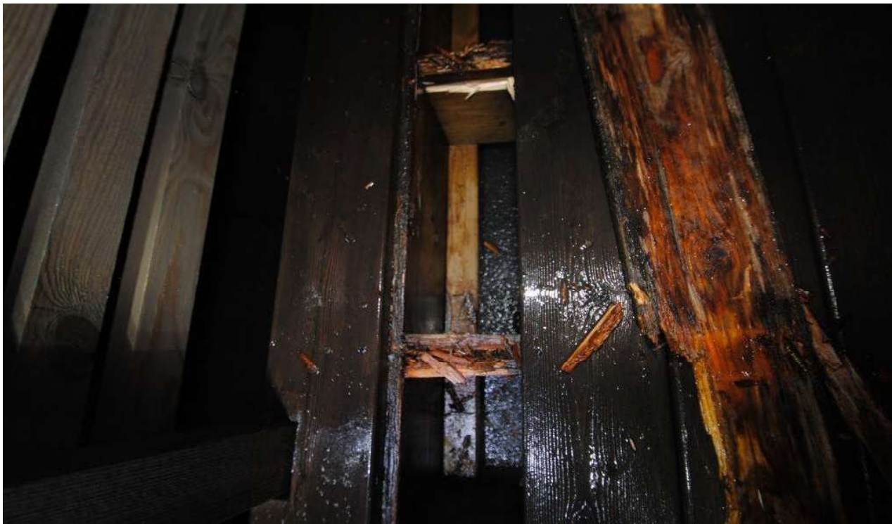
Bilde 1: Viser råteskader i bord og bjelker
