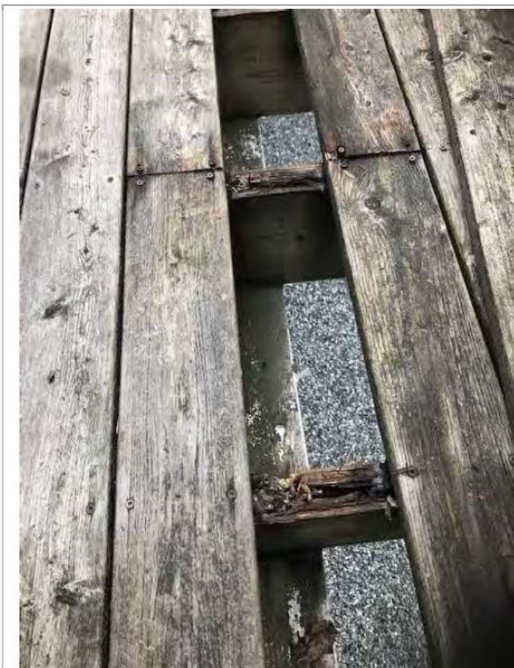
Råte skade i bærende konstruksjon
