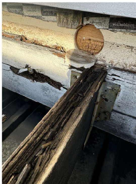
Terrassen for 329 er av en slik tilstand at det er stor fare for ras ved bruk og bør avgrensnes for tilgang, særlig mtp. barn.
