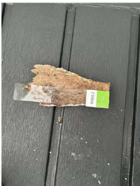
Obsvert skader tilknyttet ytterveggene, bruk av gips ment til innvendig bruk og misfarging av materialer inside vindtetting.
