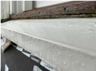
Feil montering av beslag under altandør.
