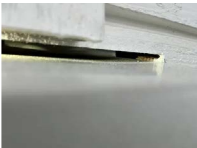
Mangler oppbrett og tilstrekkelig fuktsikring på beslag.
