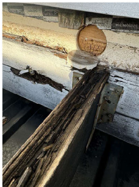
Terrassen for 329 er av en slik tilstand at det er stor fare for ras ved bruk og bør avgrensnes for tilgang, særlig mtp. barn.
