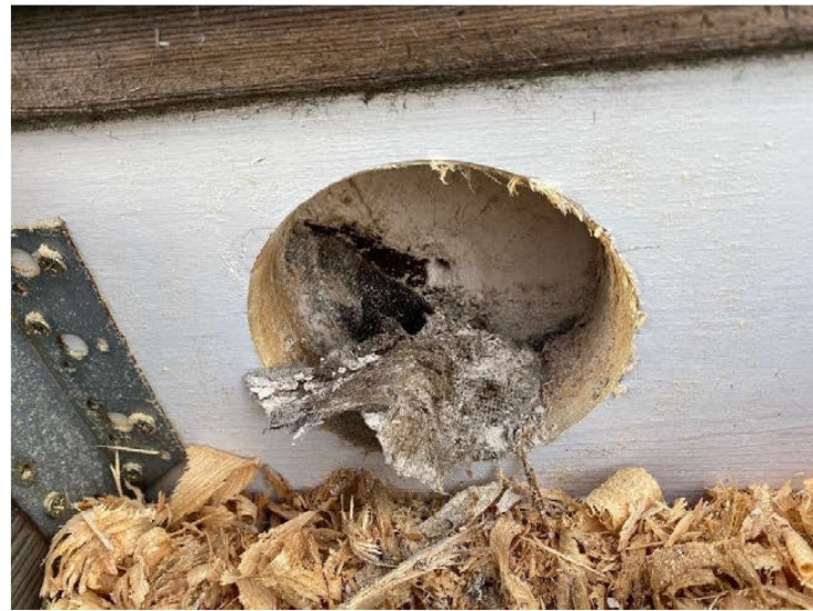
Råteskadet på kantbjelken til bjelkelaget.
