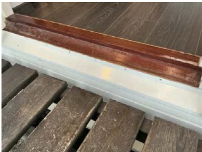
Feil montering av beslag under entrédør.
