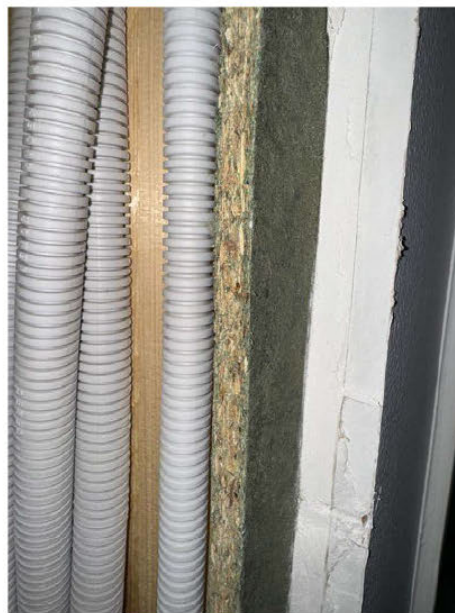
Påvist at rørføring er lagt i veggen uten skille mellom de to seksjonene.
