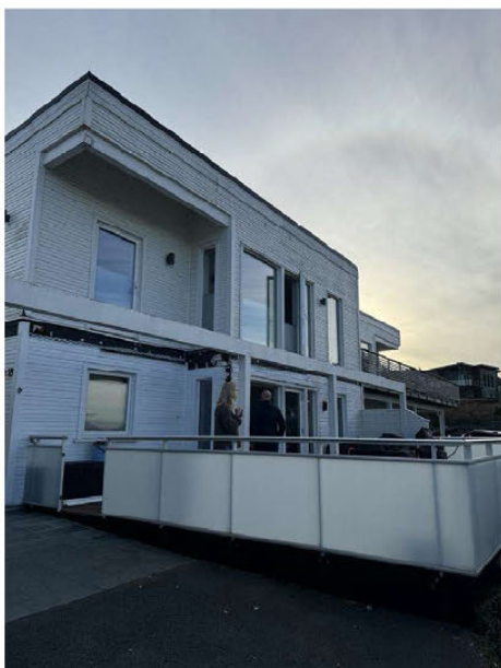
Terrasse for 331 er demontert med kun bærekonstruksjon gjenstående. Hele terrassen for 329 fremstår tilgjengelig.
