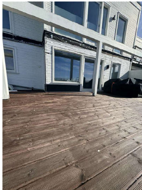
Vår befaring 04.04.2025. Vesentlig forverret tilstand i fasadekledning, også fra vår første befaring 25.10.24.
