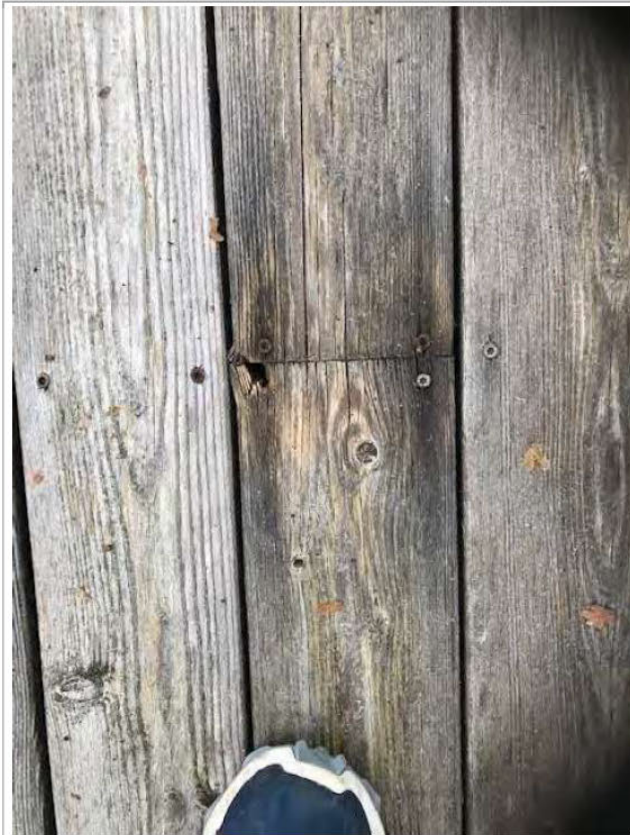
Påbegynne råte skade
