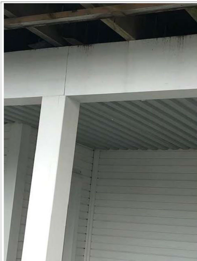
Oversikt lintre i område der det er råteskade på lintre.
