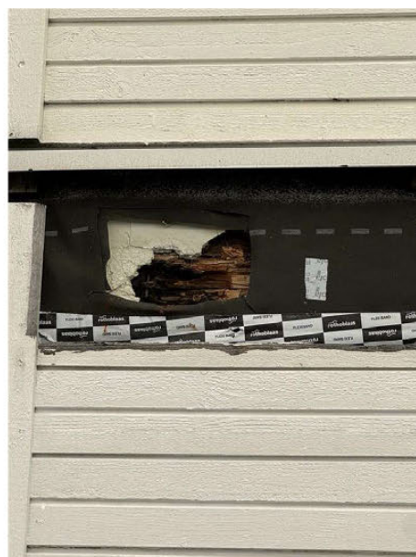
Vår befaring 25.10.2024. Skaden ser lik ut, men forverret tilstand i fasadekledning.
