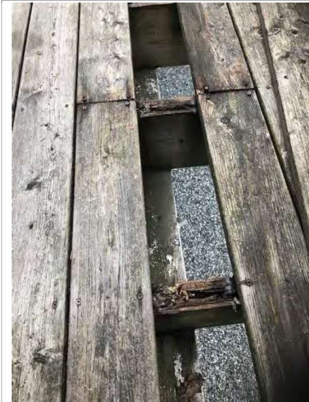
Råte skade i bærende konstruksjon
