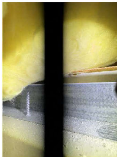
Det er ikke observert lydbøyer.
