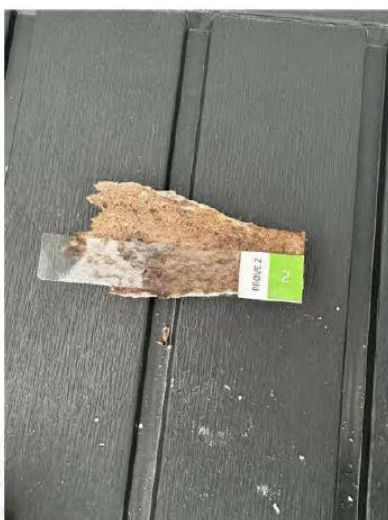
Observert skader tilknyttet ytterveggene, bruk av gips ment til innvendig bruk og misfarging av materialer innside vindtetting.
