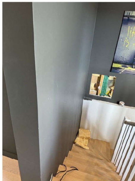
Det ble ikke registrert forhold som bryter med forskriftskrav for oppbygging av brann og lyd krav.
