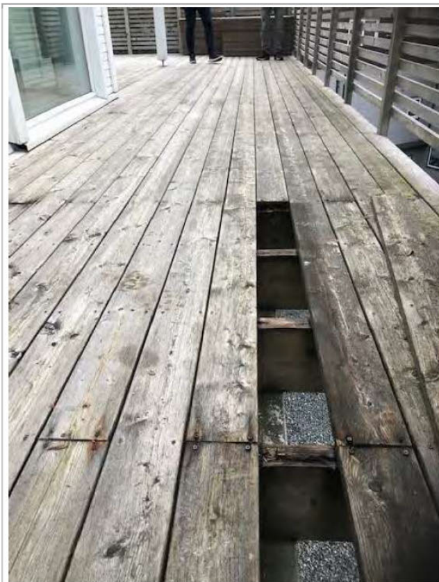
Oversikt bjelker og dekke er råteskadet
