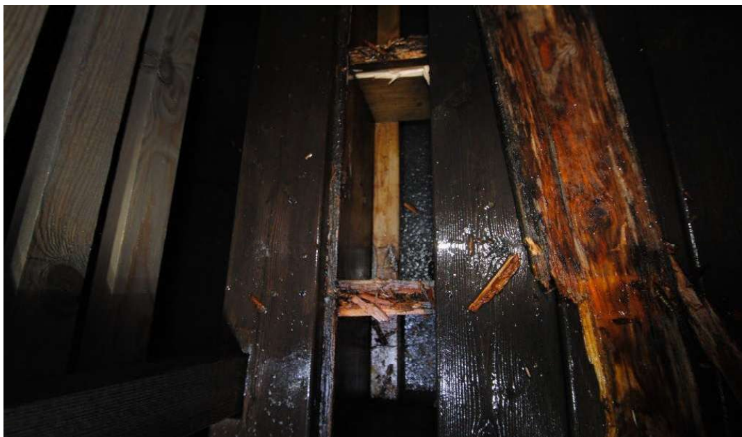
Bilde 1: Viser råteskader i bord og bjelker
