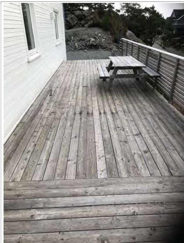
Oversikt terrasse dekket med em del råteskader
