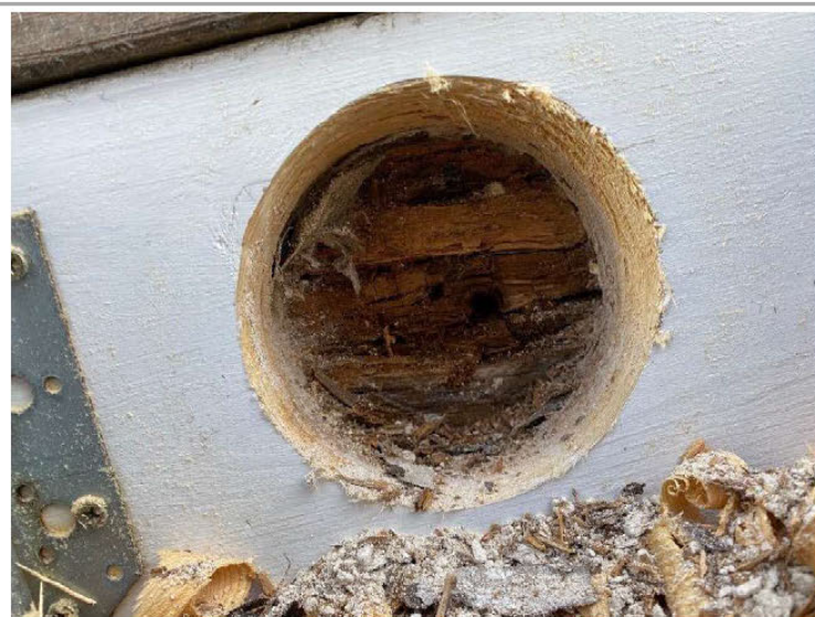
Råteskadet på kantbjelken til bjelkelaget.
