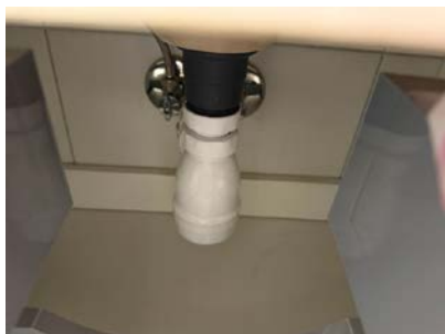
Røropplegg under baderomsinnredning
