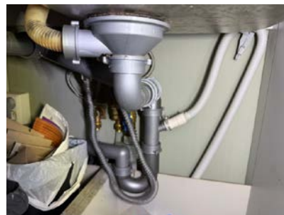
Røropplegg under kjøkkenbenk
