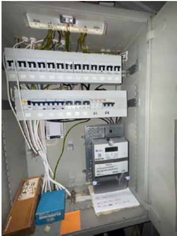
Sikringsskap plassert i gang ved kjøkken.
