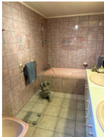
Sluk på bad i kj.etasje
