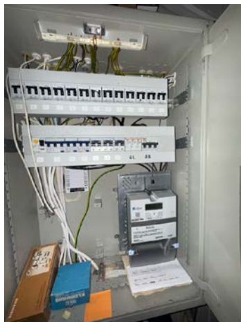
Sikringsskap plassert i gang ved kjøkken.
