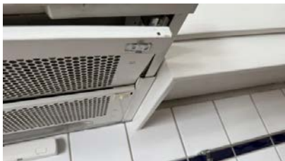
Eksempelbilde av defekt/ manglende låseknapp til fettfilter.
