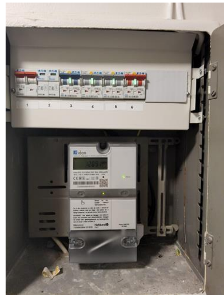
Elektrisk anlegg - [Sikringsapparat]
