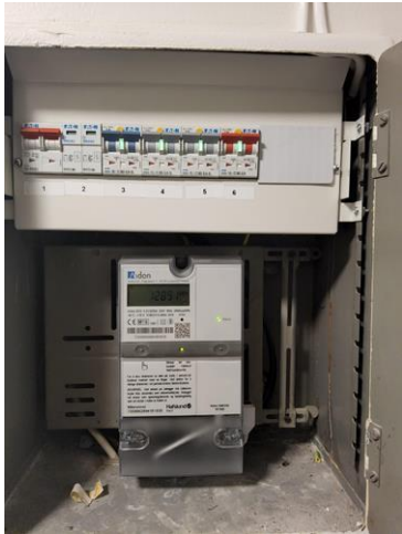
Elektrisk anlegg - [Sikringsskap]
