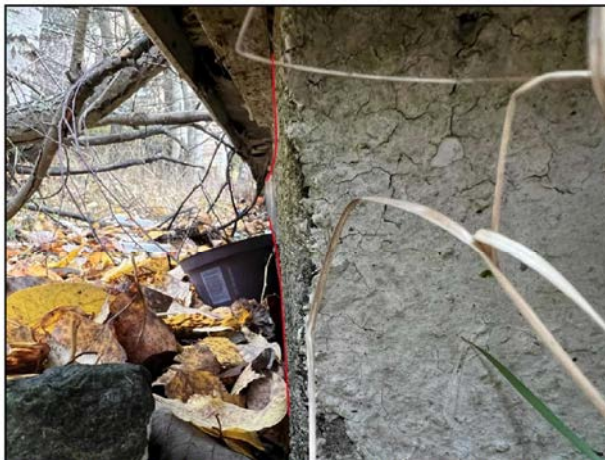
Bilde 7: Tydelig svikt i bakre betongvegg. Veggens overkant og underkant mot massene markert i rødt viser innsving. Garasjerekke felt B
