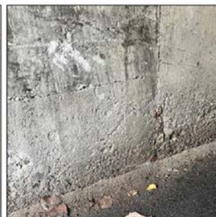
Bilde 6: Forvitret betong og løst tilslag
