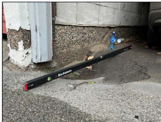
Bilde 4: Synkehull under asfalt inntil ringmur med dybde ca. 19 cm
