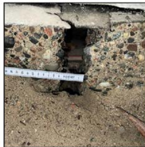
Bilde 2: 45mm sprekk i ringmur
