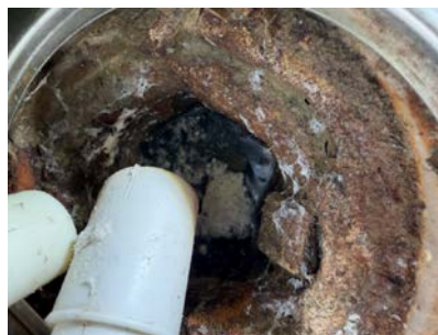
Rust i støpejernssluk
