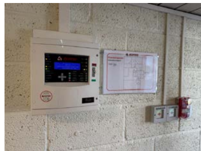
Felles brannvarslingsanlegg i bygget
