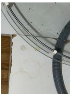
Det bemerkes bruksslitt bunnplate i hjørneskap.
