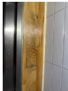
Mindre bruksmerker i benkeplate ved kran på kjøkken.
