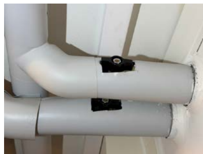
Stoppekraner rett utenfor entredøren i himling.
