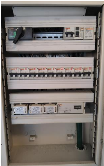
Elektrisk anlegg - [Sikringsskap sokkel]
