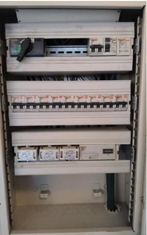
Elektrisk anlegg - [Sikringsskap sokkel]
