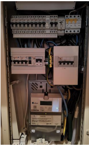
Elektrisk anlegg - [Sikringsskap ]
