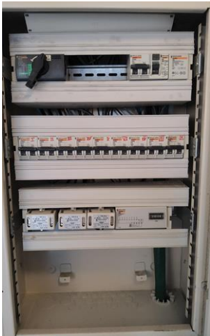
Elektrisk anlegg - [Sikringsskap sokkel]
