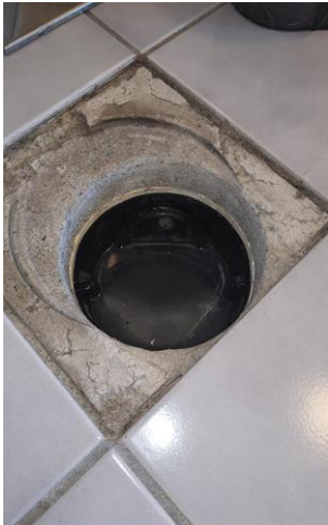
Avløpsrør (ink. sluk) - [Hovedsluk på bad 2.etasje ]
