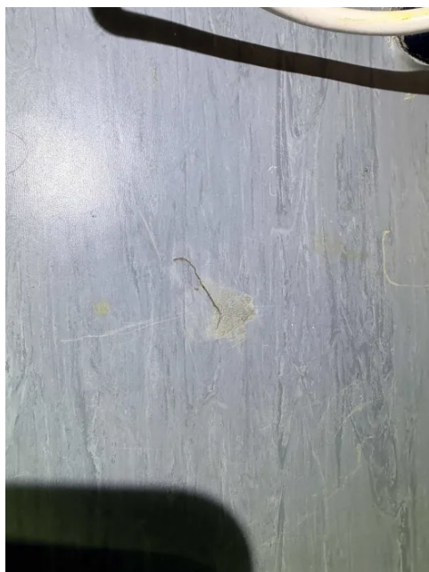
Lokal skade på gulvbelegg (område ved sluk/bereder).
