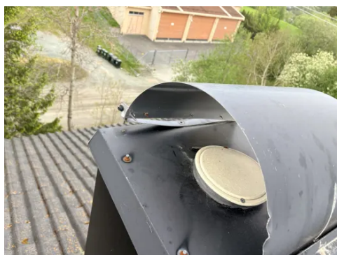
Løst beslag på pipehatt.
