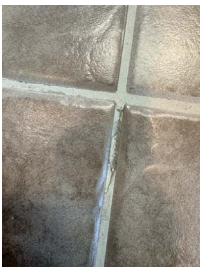
Lokal bom i gulvflis, med løsnet flisefugen som følger av bom i gulvflis.
