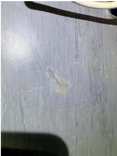
Lokal skade på gulvbelegg (område ved sluk/bereder).
