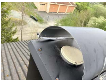
Løst beslag på pipehatt.
