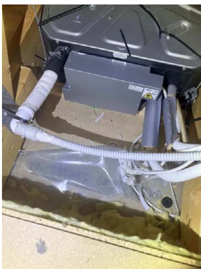
Det registreres utett dampsperre og manglende isolering rundt gjennomføring for takmontert varmepumpe.
