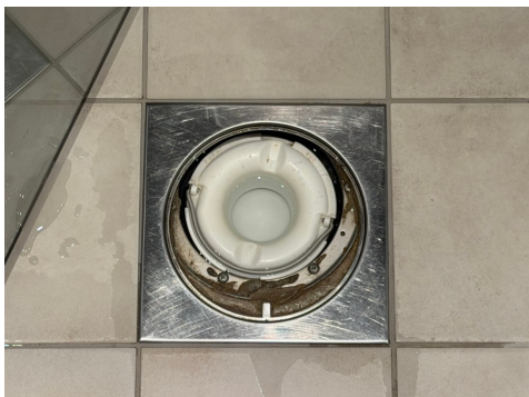
Plastsluk i dusjsone.
