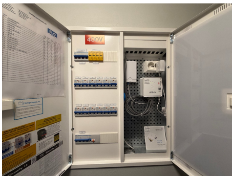
Sikringsskap i bod/teknisk rom.
