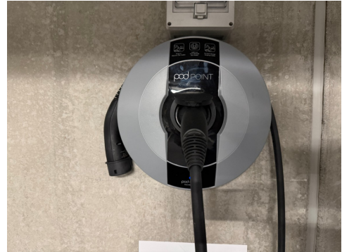
El. bil ladestasjon v/ garasjeplass.
