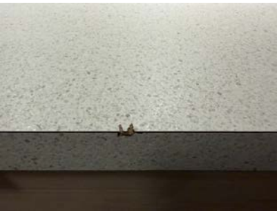
Sår på kant av benkeplate. Må anses å være normal slitasje.
