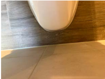
Uferdig borret drenshull under vegghengt toalett.
