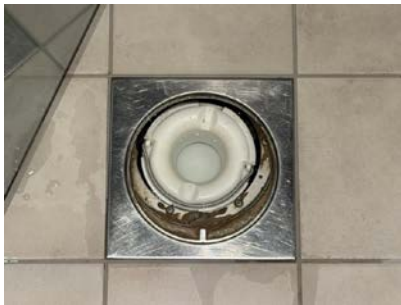
Plastsluk i dusjsone.
