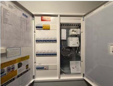
Sikringsskap i bod/teknisk rom.
