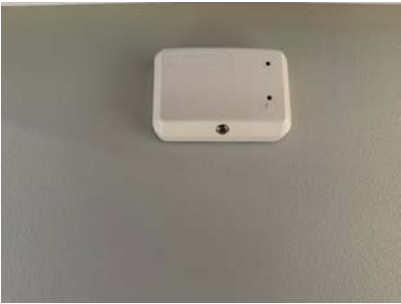
Komfyrvakt v/ kjøkkenventilator.
