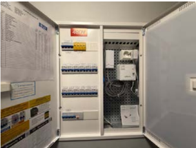
Sikringsskap i bod/teknisk rom.
