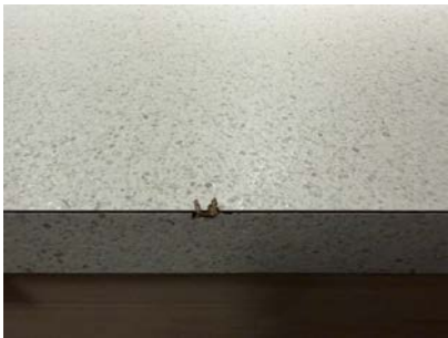
Sår på kant av benkeplate. Må anses å være normal slitasje.
