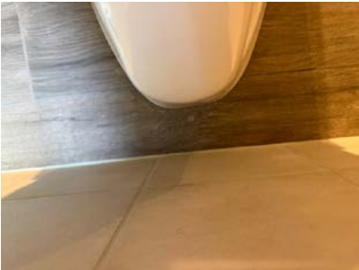
Uferdig borret drenshull under vegghengt toalett.
