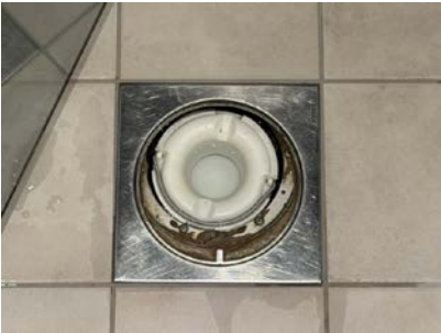
Plastsluk i dusjsone.
