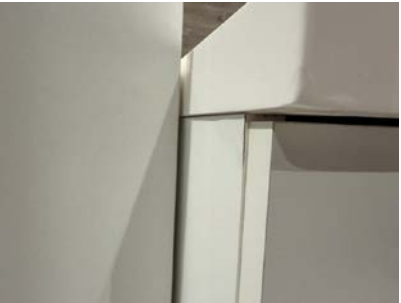
Noe svelling på siden av baderomsinnredning. Må anses å være normal slitasje.
