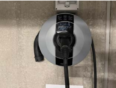
El. bil ladestasjon v/ garasjeplass.
