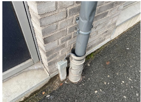
Koblingsboks ved fortau
