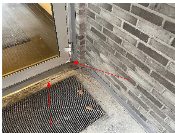
Skader på dør og betongdekke
