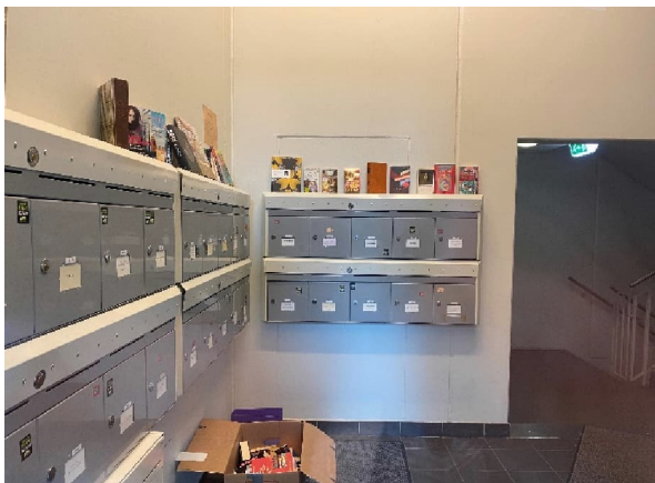
Bruksslitasje på overflater
