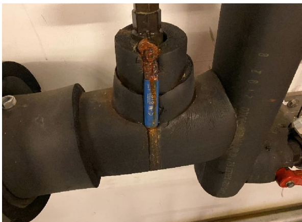
Rust på kran. Kraner må funksjonstestes regelmessig
