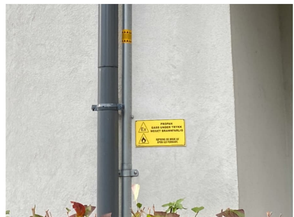
Gassrørledning på fasade
