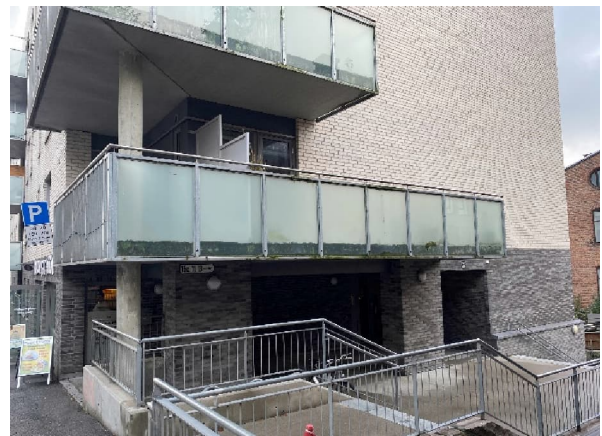
Kraftig groing på dekkekant. Tiltak er nødvendig
