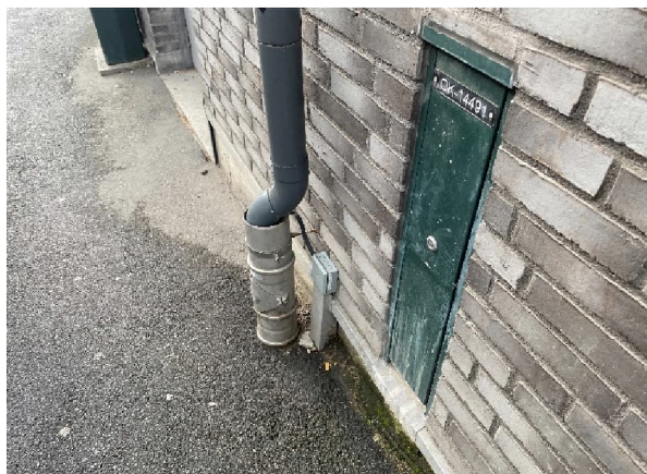
Varmekabler må kontrolleres jevnlig
