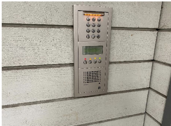
Betjeningspanel fra byggeåret
