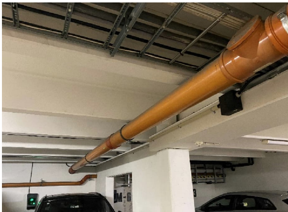
Bunnledninger er lett tilgjengelige i parkeringskjeller
