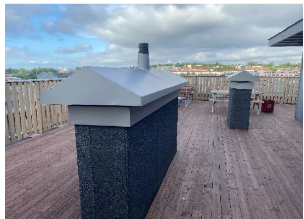
Ventilasjonsavkast over tak
