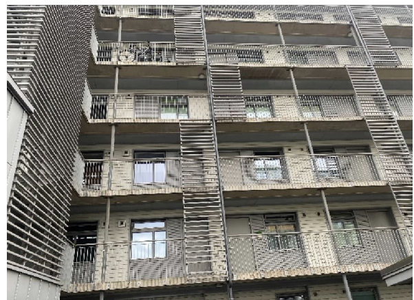
Trekledning med behov for overflatebehandling
