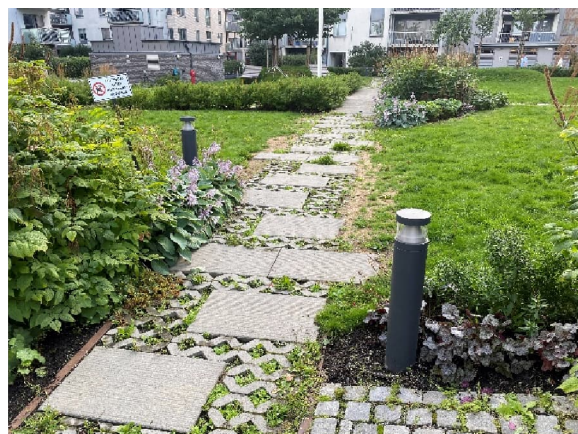
Pullerbelysning er utsatt for jordfeil
