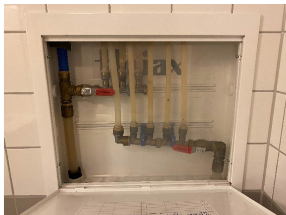
Stoppekran i bolig
