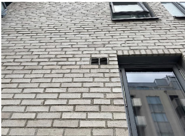
Tilluftsventil i vegg
