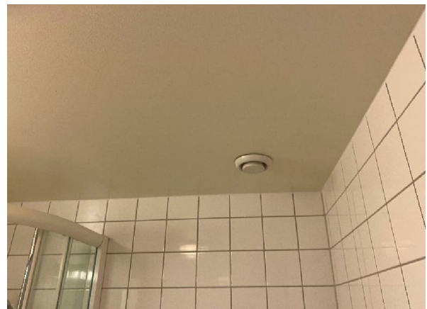
Avtrekk i våtrom
