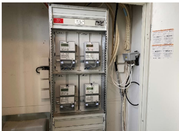
Målere i underfordelinger
