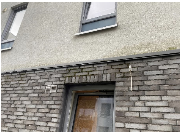
Mosegroing i fuger må fjernes.
