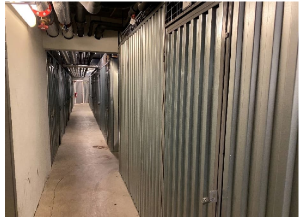
Støtskader i metallprofiler
