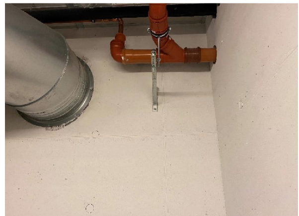
Lett tilgjengelige avløpsrør i kjeller
