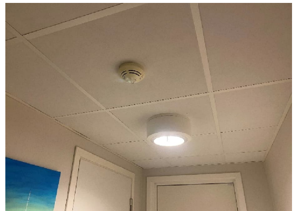
Systemhimlinger i korridorer med enkelte skader
