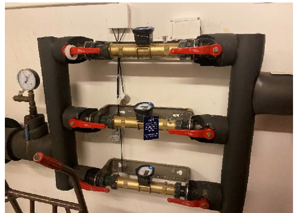
Vanninnlegg med målere
