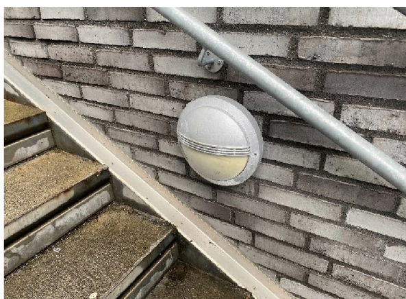
Belysningsutstyr fra byggeåret
