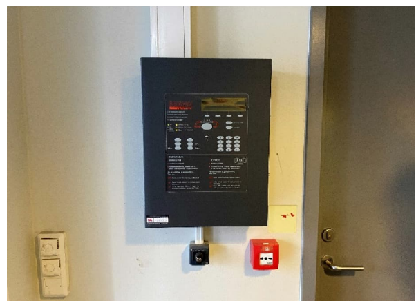
Brannpanel i oppgang med serviceavtale
