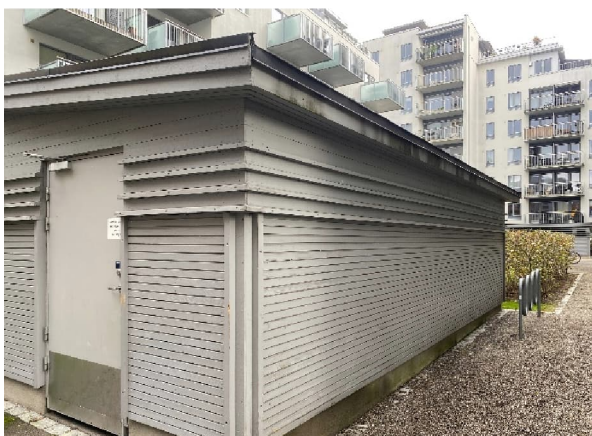
Frittstående avfallshus med behov for overflatebehandling
