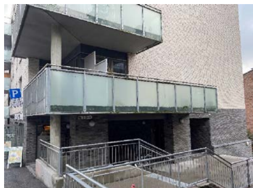
Kraftig groing på dekkekant. Tiltak er nødvendig
