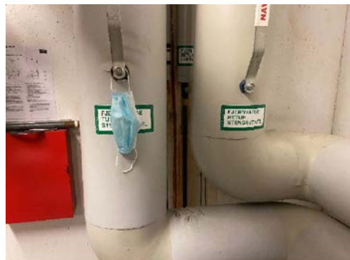
Stengeventiler for fjernvarme
