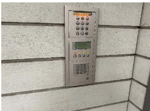
Betjeningspanel fra byggeåret
