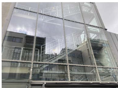
Trapper i materialer av galvanisert stål
