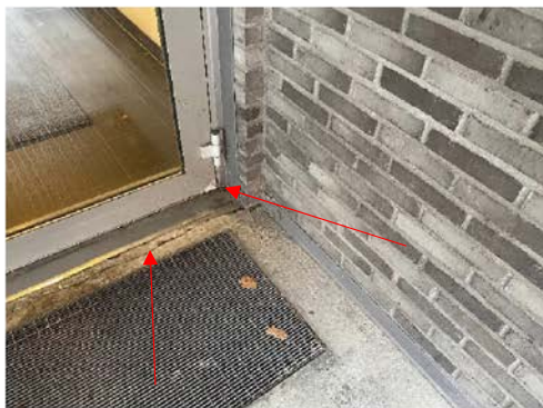
Skader på dør og betongdekke
