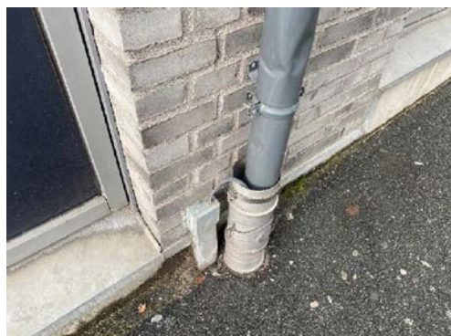
Koblingsboks ved fortau
