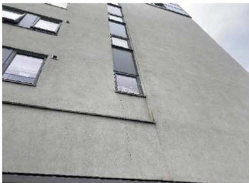
Behov for rengjøring av alle fasader
