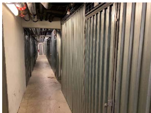
Støtskader i metallprofiler
