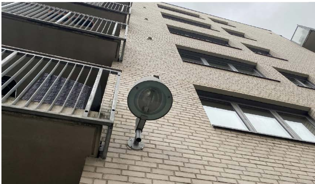
Belysningsutstyr på fasade
