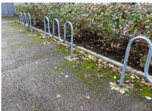
Mose bør fjernes løpende
