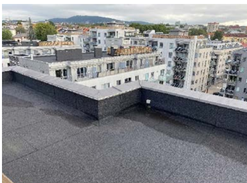
Defekt varmekabel vil føre til skader
