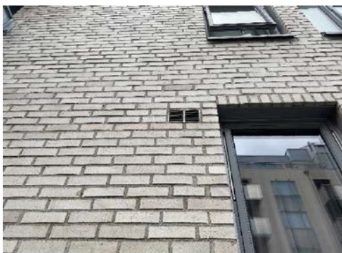
Tilluftsventil i vegg
