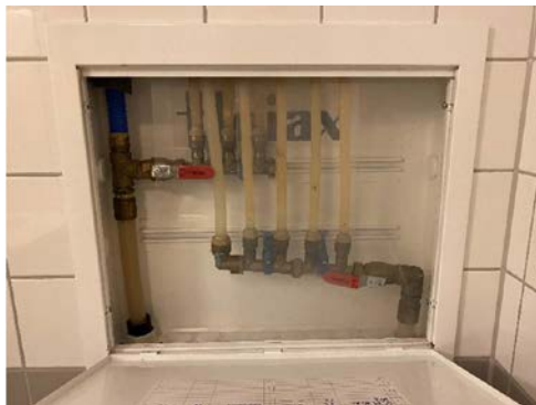
Stoppekran i bolig
