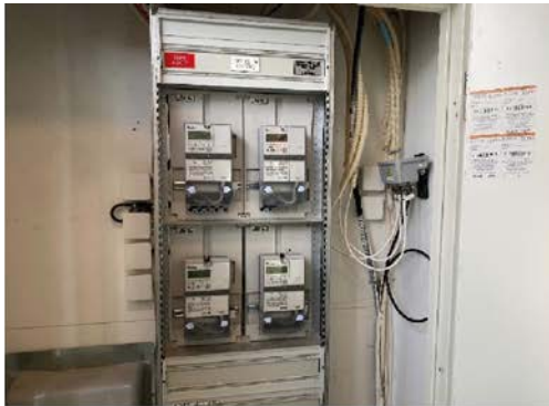
Målere i underfordelinger
