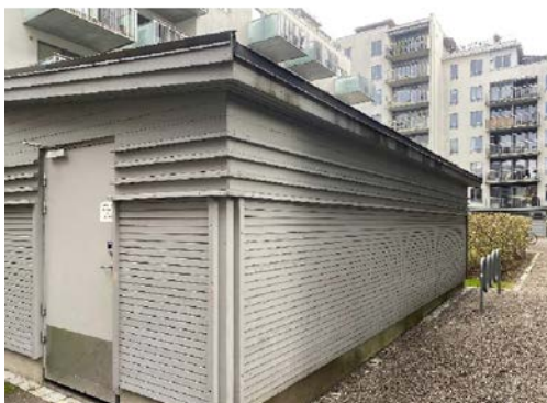
Frittstående avfallshus med behov for overflatebehandling
