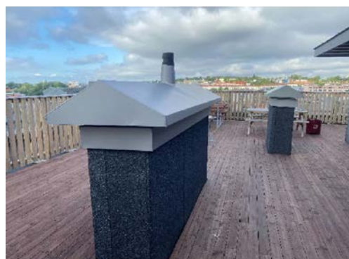
Ventilasjonsavkast over tak
