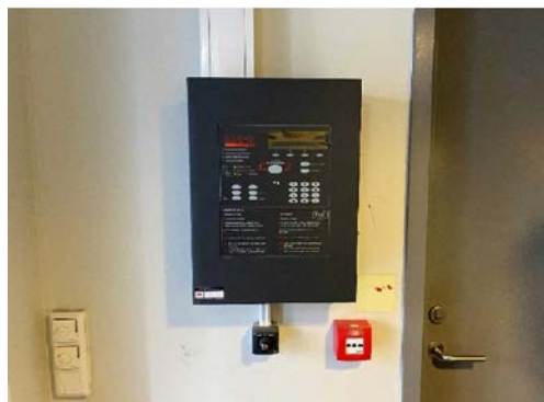
Brannpanel i oppgang med serviceavtale
