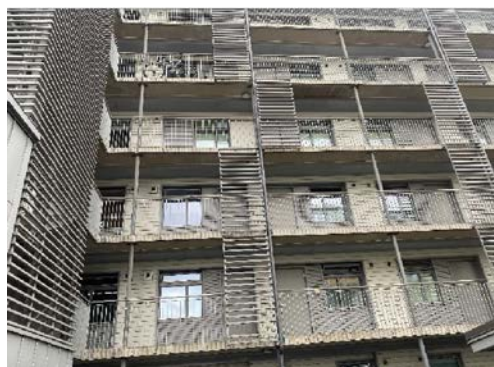
Trekledning med behov for overflatebehandling
