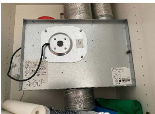
Aggregat i bolig. Vedlikeholdsinstruks må følges
