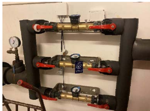
Vanninnlegg med målere
