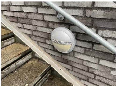
Belysningsutstyr fra byggeåret
