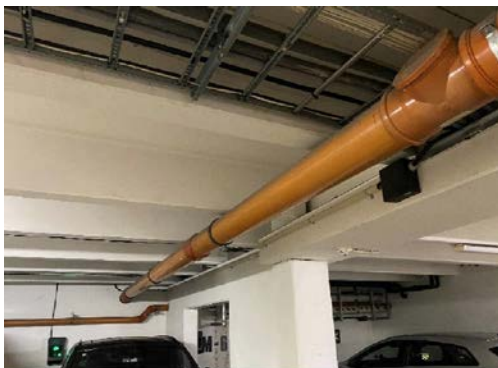
Bunnledninger er lett tilgjengelige i parkeringskjeller
