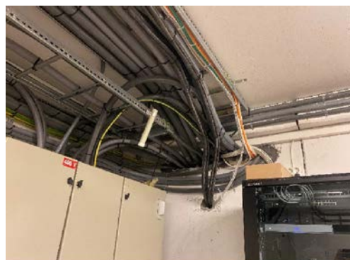
Stigeledninger i tavlerom
