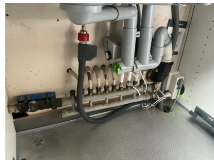
Stoppekran i kjøkkenskap
