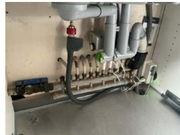
Stoppekran i kjøkkenskap
