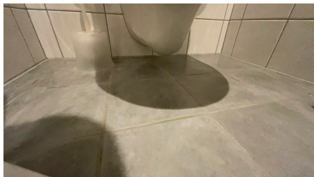
Lekkasjespalte på innebygget sistene bør opparbeides.
