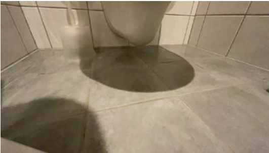
Lekkasjespalte på innebygget systerne bør opparbeides.
