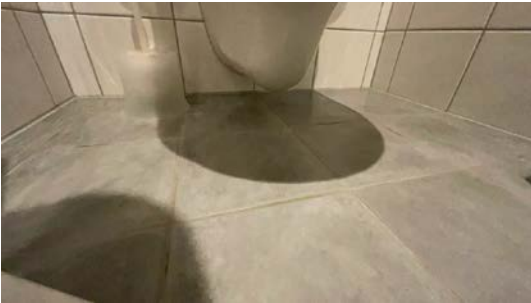
Lekkasjespalte på innebygget systerne bør opparbeides.
