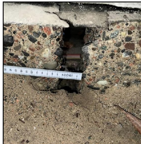
Bilde 2: 45mm sprekk i ringmur
