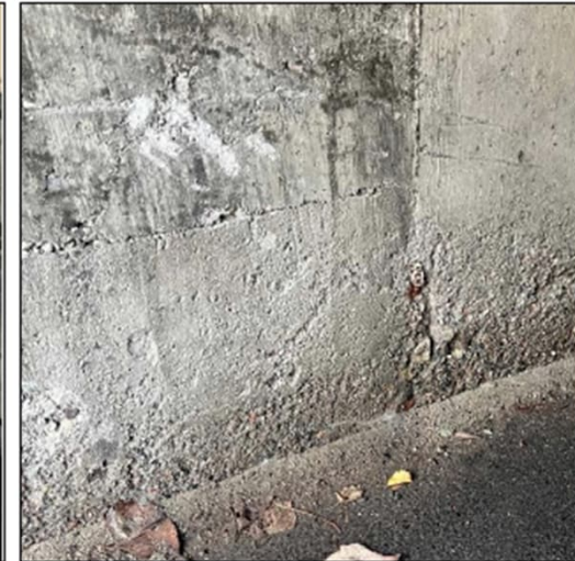
Bilde 6: Forvitret betong og løst tilslag
