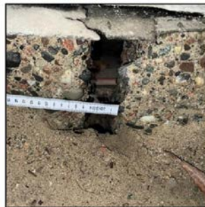
Bilde 2: 45mm sprekk i ringmur
