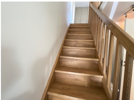
Trapp mangler håndløper. Se eget punkt under «HMS-avvik».
