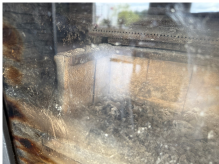
Sprekk i ildfast stein
