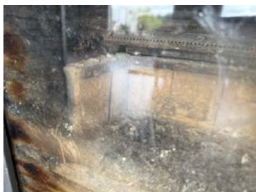
Sprekk i ildfast stein
