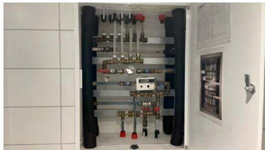
Rørskap med samlestocker og stoppekraner.
