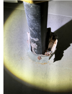
Avvik med membran rundt gjennomføring
