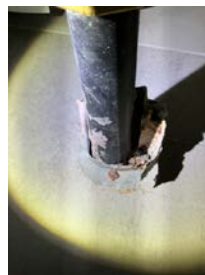
Avvik med membran rundt gjennomføring
