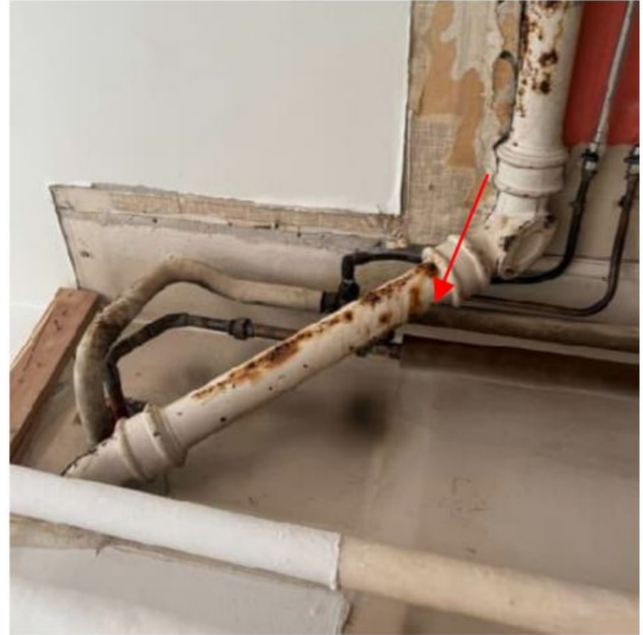
Avløpsrør med rustdannelser
