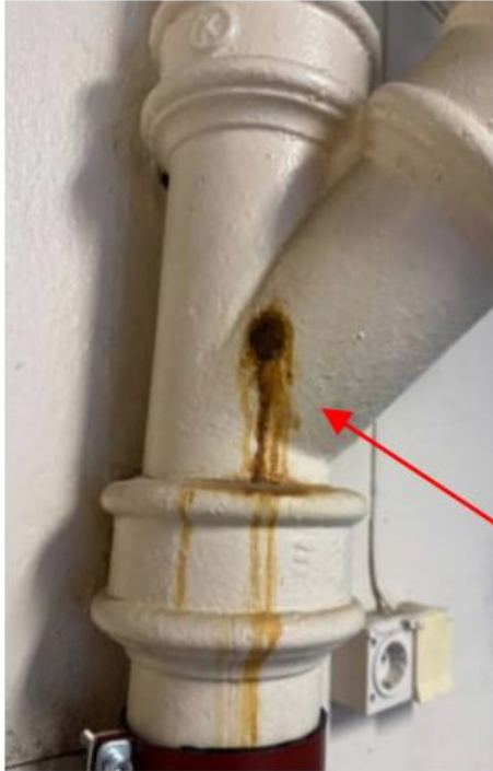
Avløpsrør med rustdannelser
