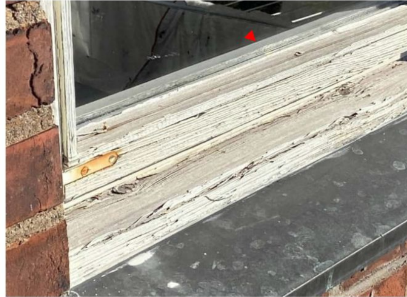
Store mangler på vinduer i 9 etasje
