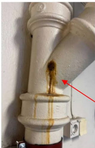
Avløpsrør med rustdannelser
