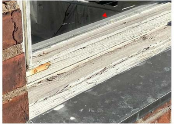
Store mangler på vinduer i 9 etasje
