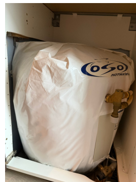
Varmtvannstank i kjøkkenskap.
