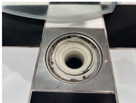
Plastsluk i dusjsone.
