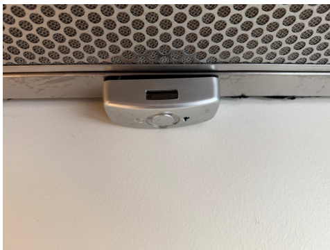
Komfyrvakt v/ kjøkkenventilator.
