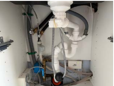
Røropplegg og aquastop under vask. Ny aquastop i 2025.
