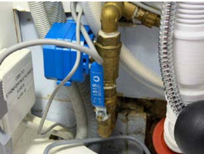
Stoppekran i kjøkkenskap.
