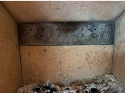
Riss inni ildfast stein i peisovn. Ildfast stein bør skiftes dersom riss utvikler seg til en større sprekk.
