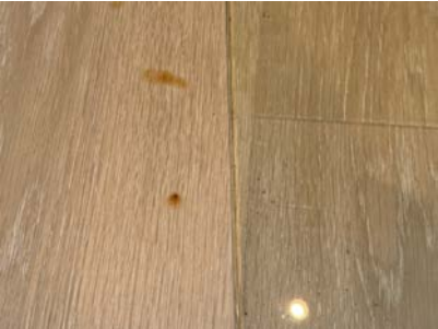
Svimerke i gulv i stue.
