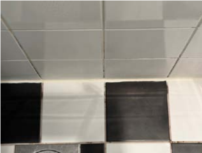
Slitasje i fuger i dusjsone.
