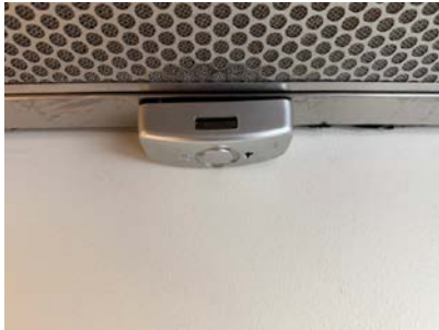
Komfyrvakt v/ kjøkkenventilator.
