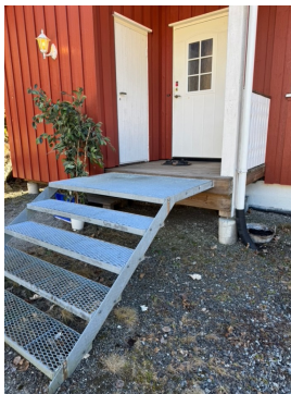
Trapp ved inngangspartiet mangler rekkverk
