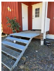
Trapp ved inngangspartiet mangler rekkverk
