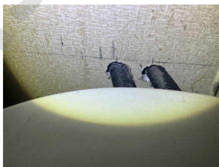
Ikke tilfredsstillende gjennomgang av rørføring
