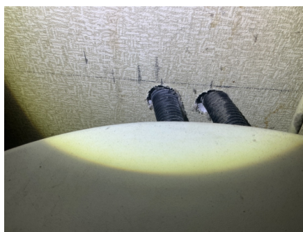
Ikke tilfredsstillende gjennomgang av rørføring
