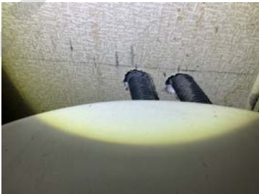
Ikke tilfredsstillende gjennomgang av rørføring
