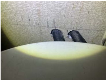
Ikke tilfredsstillende gjennomgang av rørføring
