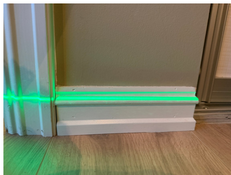
Bilder viser skjevheter i gulv i stue.
