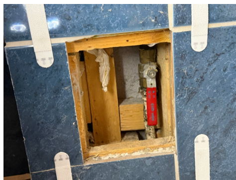
Stoppekran på bad.
