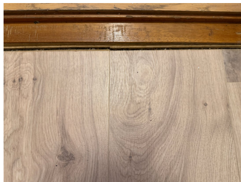
Det mangler overgangslist mellom laminat - ytterdør.
