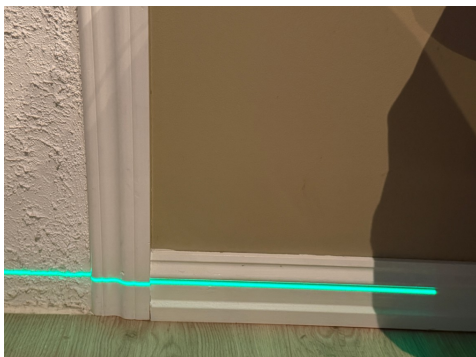
Bilder viser skjevheter i gulv i stue.
