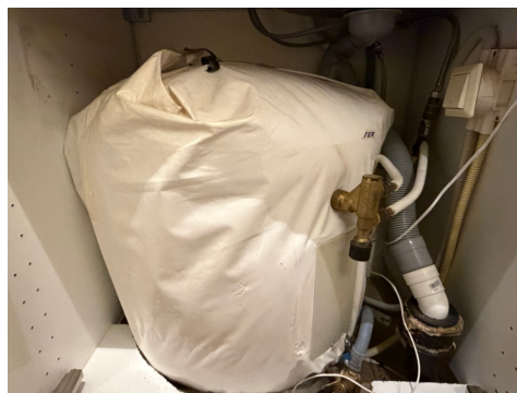
Varmtvannstank i kjøkkenskap.
