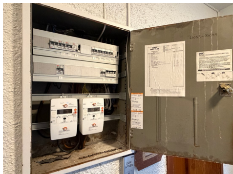
Sikringsskap i fellesarealer.
